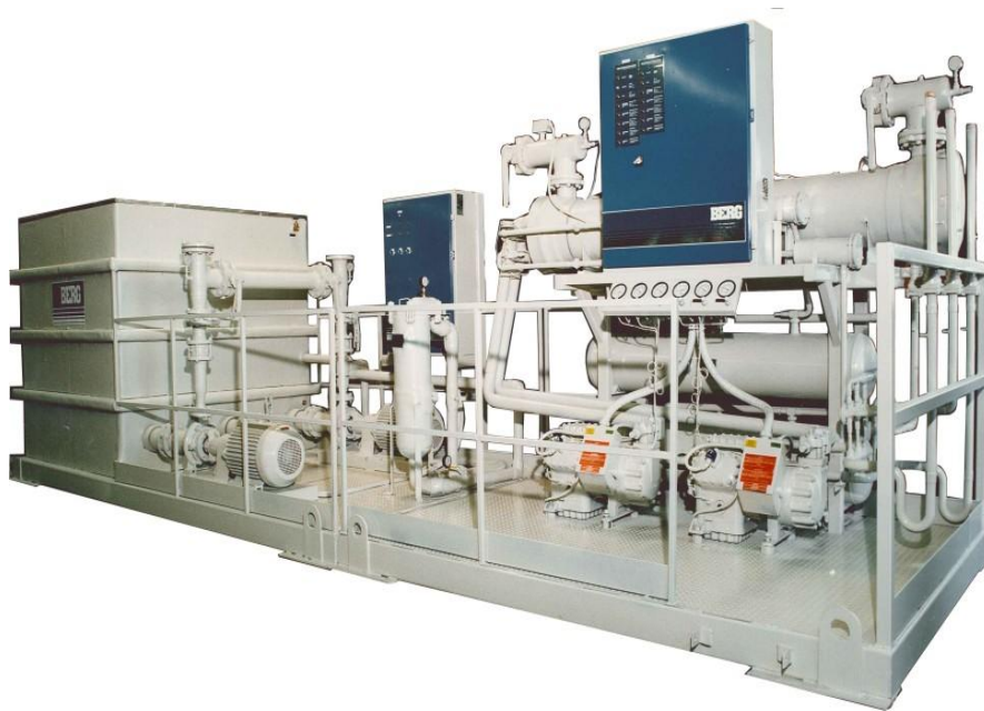
شكل (35) مبرد مياه مركزى (تشيلر)
